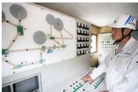
安全と工程を管理する制御盤(コントロール室)
